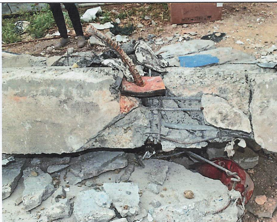
Figura 12: Anclaje de viga insuficiente
